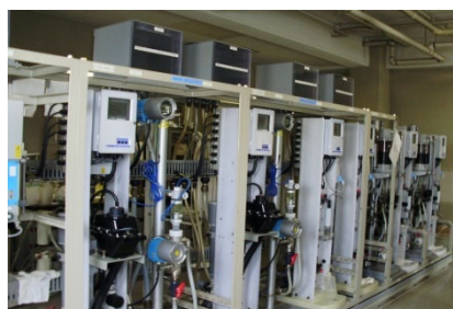
坂口浄水場 水質計器室
