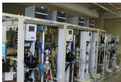
坂口浄水場 水質計器室
