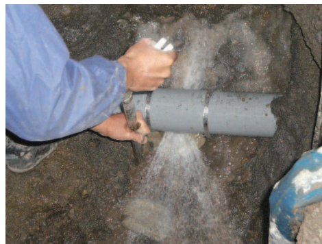
写真 5.1 老朽管からの漏水
