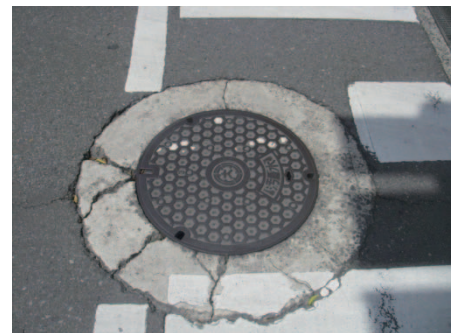
写真 5.1 老朽化したマンホール
