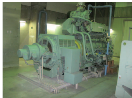
写真 5.3 自家発電機（電気設備）
