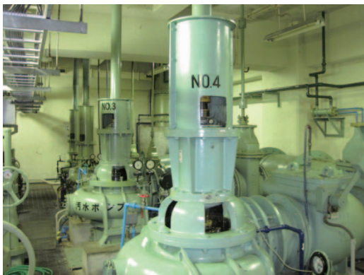
写真 5.2 汚水ポンプ（機械設備）
