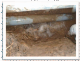
大村市平町の漏水事故 (平成26年5月)
