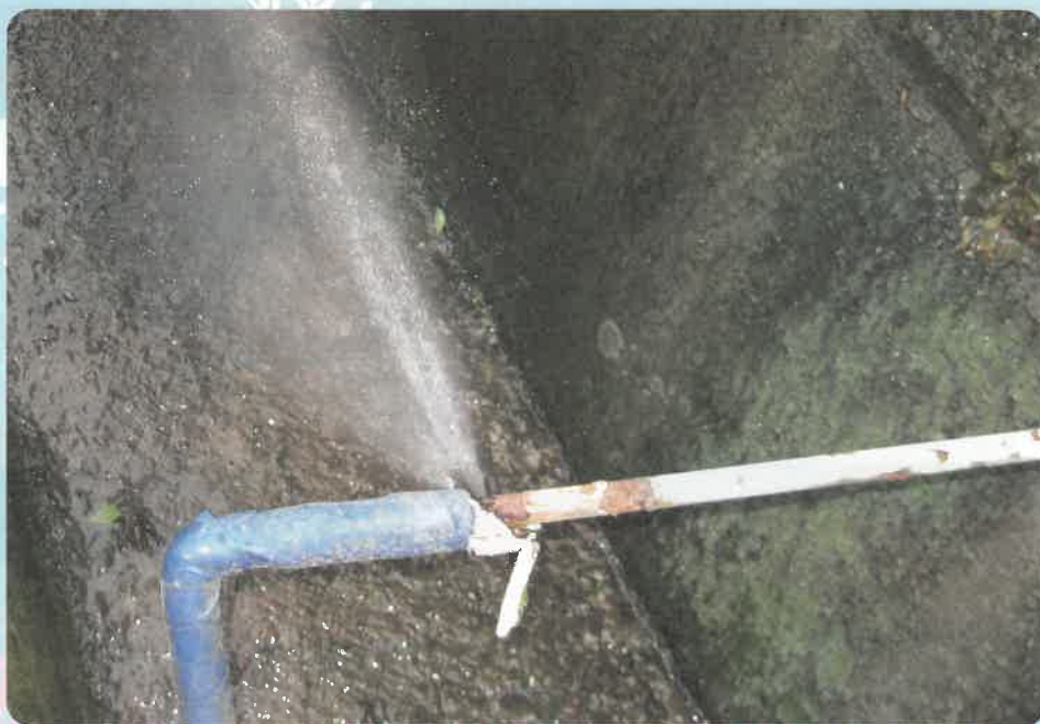
露出配管からの漏水状況
