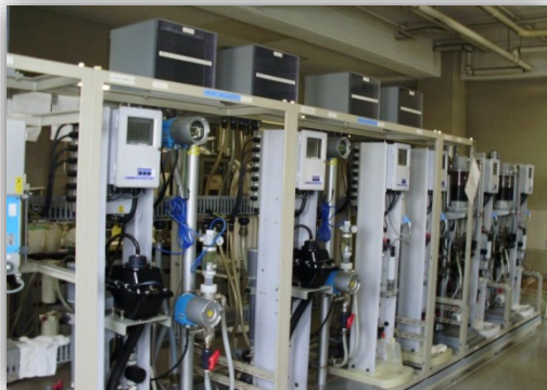
坂口浄水場 水質計器室
