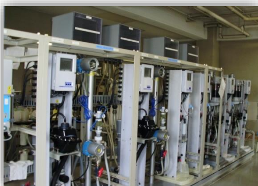
坂口浄水場 水質計器室
