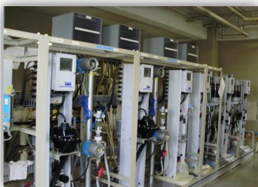
坂口浄水場 水質計器室
