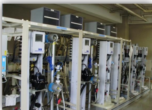
坂口浄水場 水質計器室
