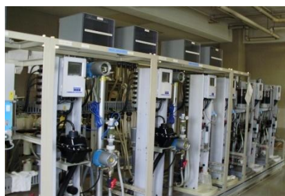
坂口浄水場 水質計器室
