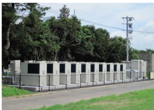
写真2.3 消化ガス発電設備
