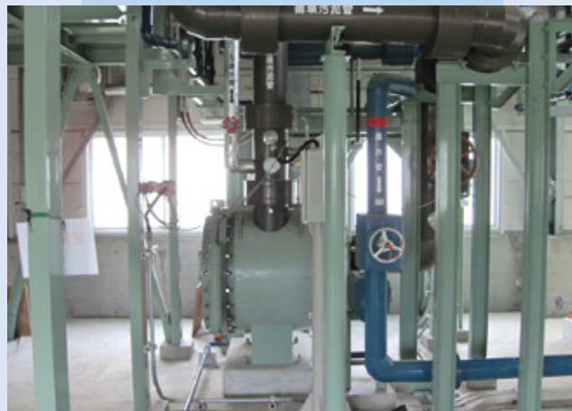
汚泥熱交換器
