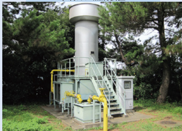
余剰ガス燃焼装置
